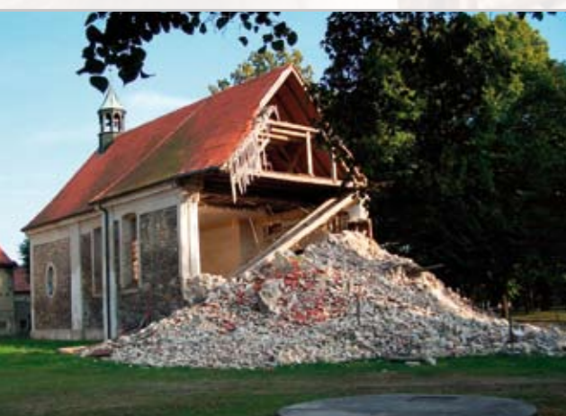
Stav objektu po pádu věže v roce 2008.
